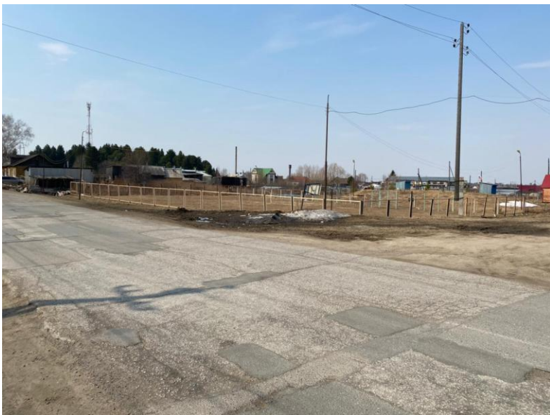
Парковка автотранспорта и доступность для маломобильных граждан отсутствует
